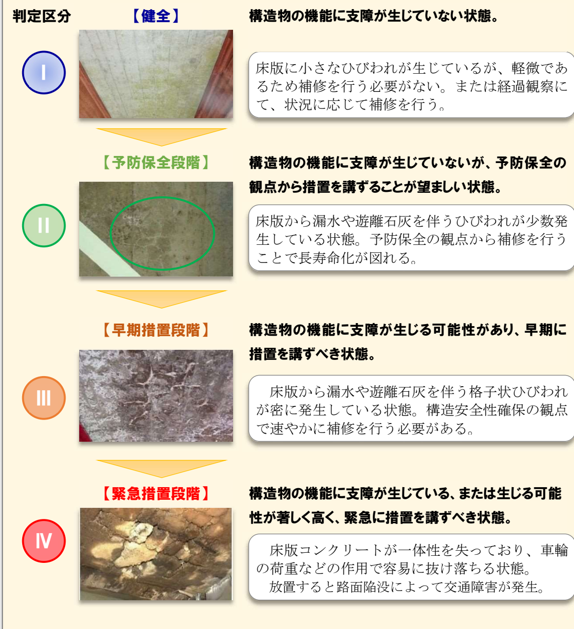
図 13 橋の健全度の事例
