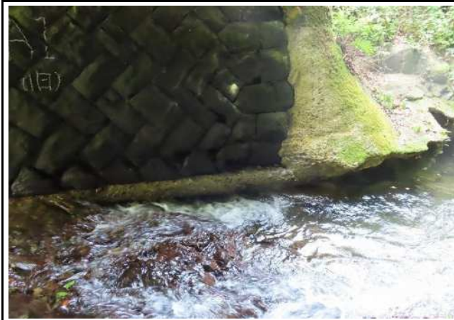
洗掘 (健全度Ⅲ) 1962年架設
