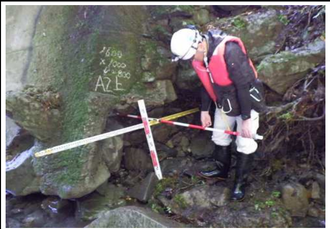
洗掘 (健全度Ⅲ) 1975年架設
