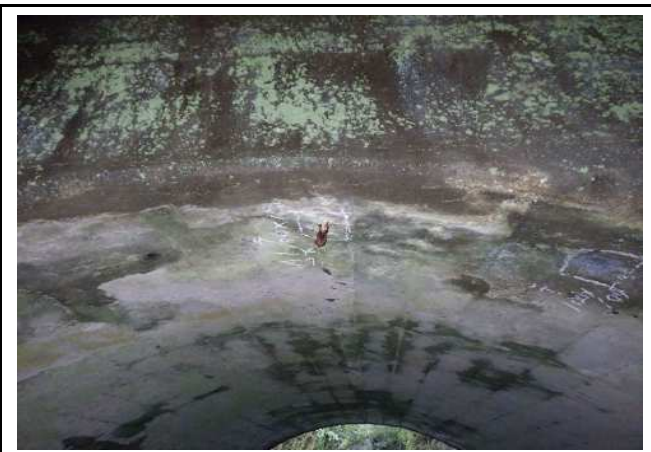
剥離・鉄筋露出 (健全度Ⅱ) 1979年架設
