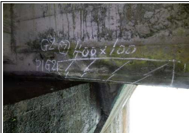
うき (健全度Ⅱ) 1965年架設
